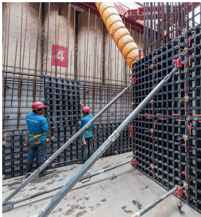
Malá hmotnost, panely bednění malých rozměrů – tyto výhody systému DUO se plně projevují u těchto podzemních stěn
